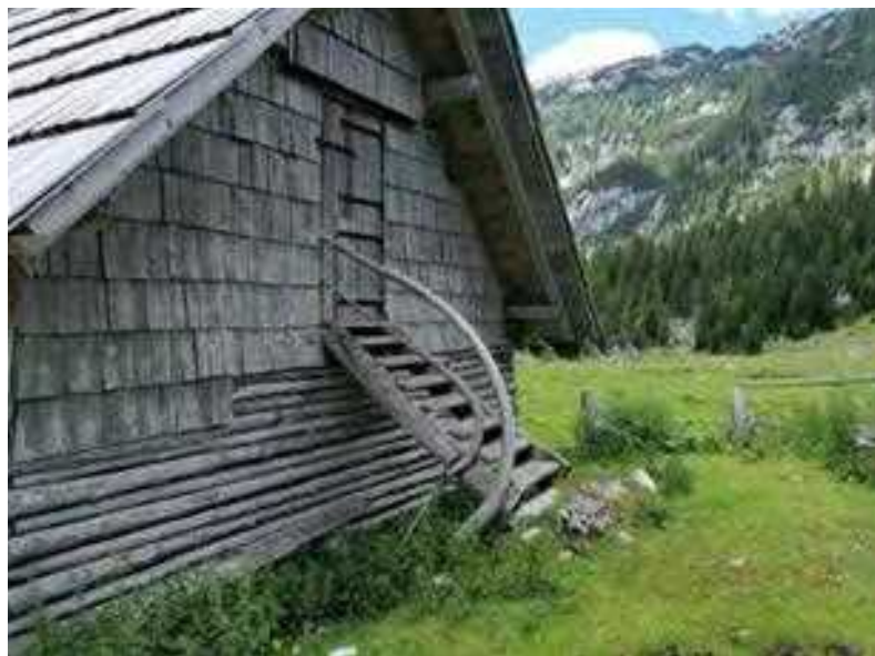
Razlikovanje v podrobnostih zrcali izvorno in sprotno prilagajanje stopnic zahtevani višinski razliki in uporabnosti prostorov. Planina Dedno polje (zgoraj). Planina Laz (spodaj). Planina Zajavornik (desno).
