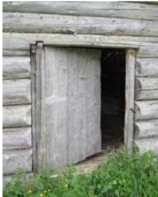
Videz najstarejše in najbolj preproste konstrukcije zapiranja vratne odprtine s stavbnim pohištvom. Planina Zajavornik
