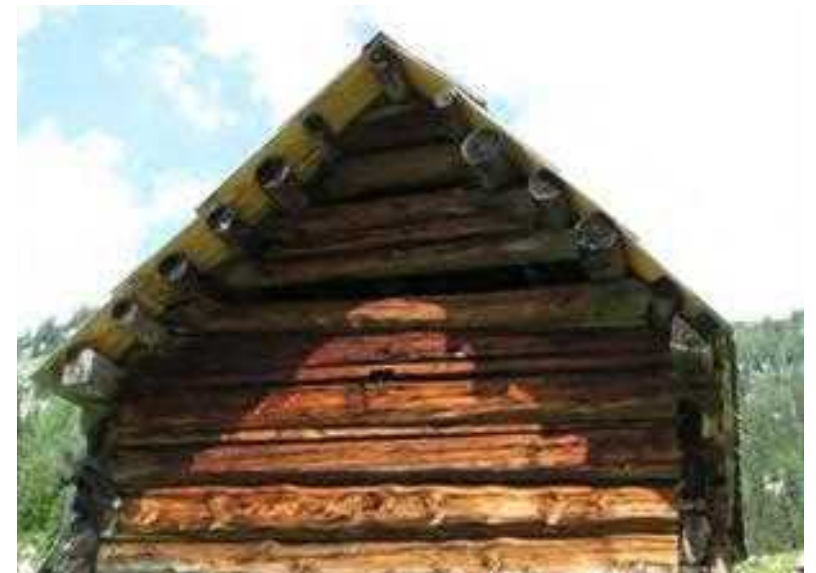
Prikaz značilne in identitetne konstrukcije ostrešja z legami – »na kašto«, brez in s čopom. Planina Dedno polje (Vir: Delavnica FA in TNP)
