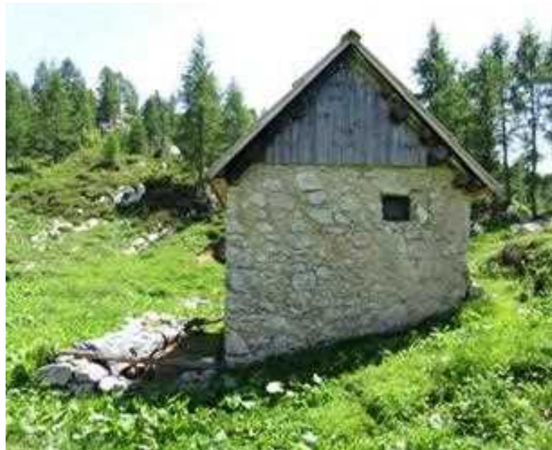
Del zunanjega ovoja tvorijo kamnite stene, izdelane z malto iz grobo obdelanega naravnega kamna. Planina Ovčarija
