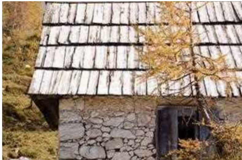
Ovoj iz kamnitega zidu iz neobdelanega lomljenca je utrjen z apneno malto in vogalnimi vezmi, kamnoseško obdelanimi večjimi kamni. Planina Ovčarija, sirarna
