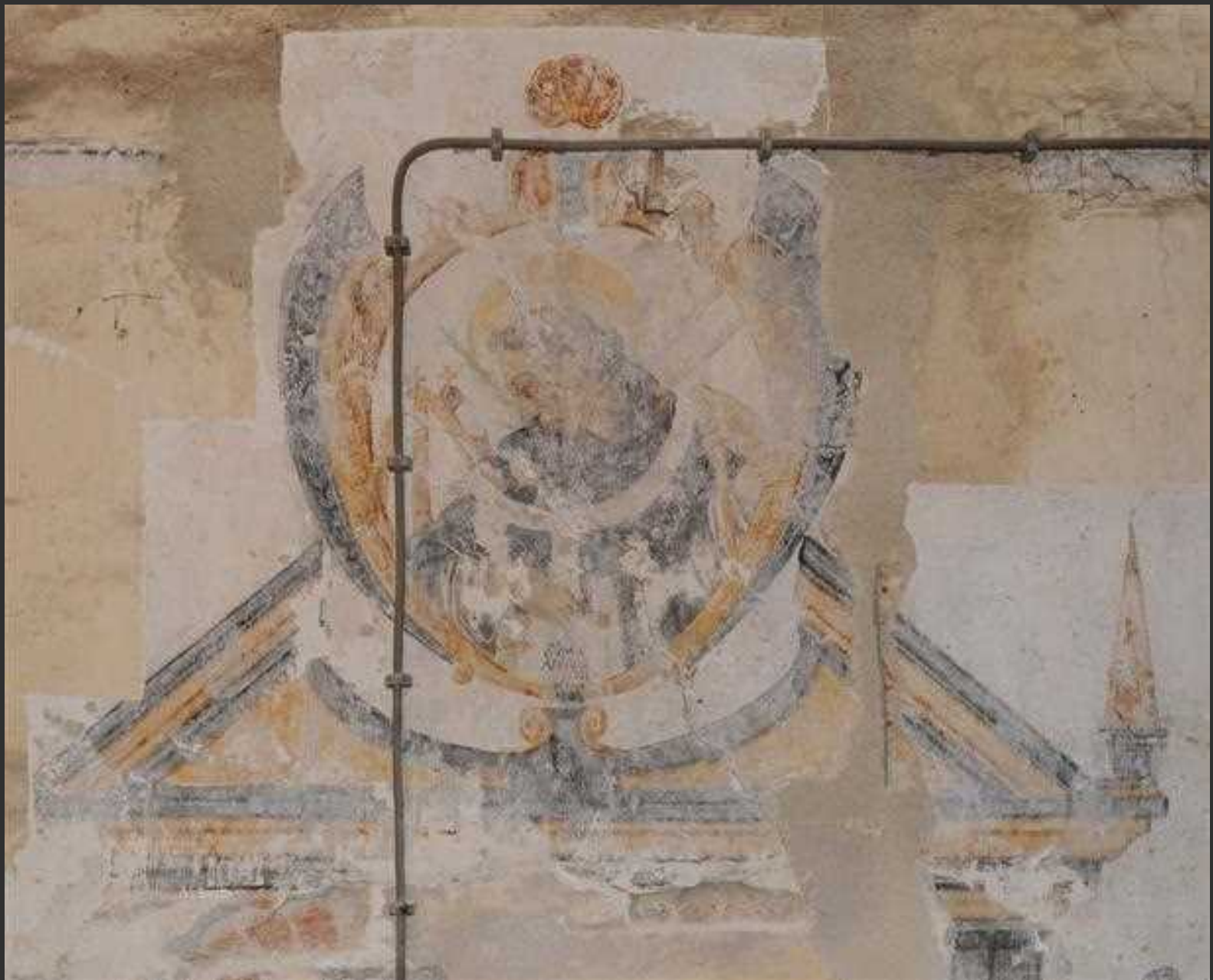
Novoodkrite stenske slike iz 17. stoletja v hodniku južnega trakta z novodobnimi poškodbami zaradi električne napeljave brez predhodnih raziskav
