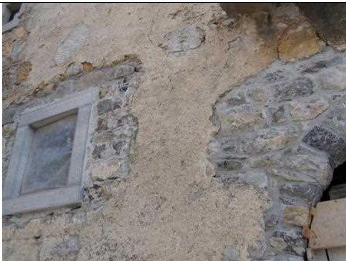
Primer ometa na fasadi hiše Lemut v Štanjelu, 2006
