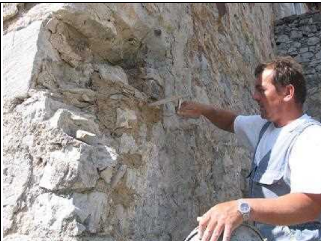
Primer na objektu hiše Markočič Štanjel, vogalna poškodba zidu
