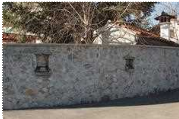
[55] Pretirana uporaba malte izniči lepoto kamna. Slepa okna na zunanji strani zidu so nefunkcionalna in niso v okras. F.: E. Belingar
