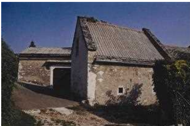
Slika 7 Slamnato streho na gospodarskih poslopijih pri Mohorajevih v Vogljah so prekrili z valovitimi salonitnimi ploščami. Ohranjene so še apnenčeve skrile na zatrepih in kapih.
