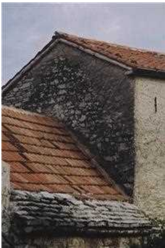
Slika 5 Nekdanja slamnata streha na stari kuhinji in hramu pri Poljkovih v Povirju, na kateri so se ohranile skrile na kapu in zatrepu, slama pa je bila nadomeščena z opečnim zareznikom. Na zatrepni steni stanovanjske hiše na desni je videti obris strmega zatrepa nekdanje skrlnate strehe.
