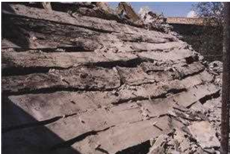
Slika 9 Del ostrešja skrilnate strehe skednja pri Slamčevih v Pliskovici z debelimi hrastovimi krajniki, ki so pribiti z manjšimi lesenimi klini. Ti klini so bili hkrati tudi sidra proti zdrsu kritine. Foto Viliem Perčič.
