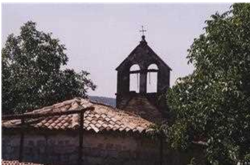
Slika 56 Cerkev sv. Tomaža v Famljah: na hrbtni strani zvončnice je videti sled nekdanje strme skrilnate strehe, ki je bila zamenjana s položno korčno streho.
