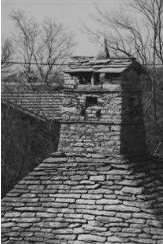
Slika 29 Dimnik na spahnjenici pri Kavalinovich v Povirju ima dva tenka skrilnata odkapnika, na skrilnati strešici pa enega izmed redkih ohranjenih stožčastih nastavkov.
