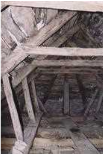
Slika 16 V cerkvi sv. Petra v Povirju so bili škarniki nad prezbiterijem kasneje podprti s poševnimi oporniki.
