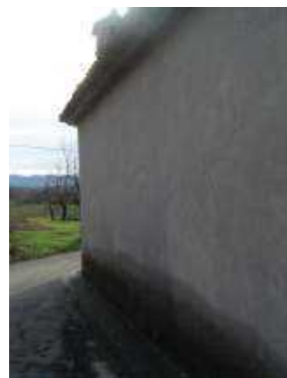
Streha brez žlebov in nepravilno izveden stik stavbe s tlemi omogoča pronicanje velikih količin vlage direktno v steno stavbe. Avtor fotografije: Nataša Kolenc
