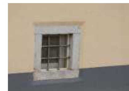
Nanos predebele izolacije na zunanjih stenah povzroči »potopitev« tradicionalnih okenskih in vratnih okvirjev v fasado.
