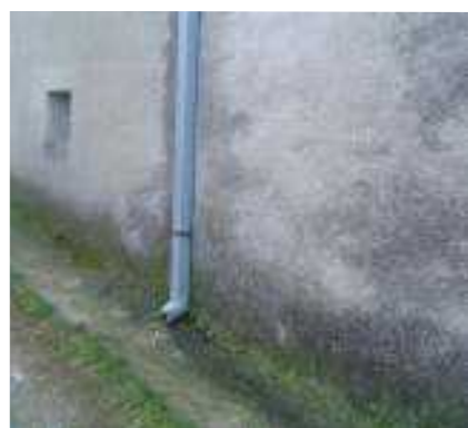
Pomanjkljivo urejeno odvodnjavanje strešnih vod povzroča dobesedno zlivanje vode v steno in posledično njihovo propadanje • Avtor fotografije: Nataša Kolenc
