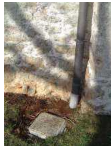
Strešna voda, speljana v meteorno kanalizacijo preko peskolova - jaška, ki zadrži trde delce. V primeru odvajanja deževnice v štirno so bili tradicionalno uporabljeni tudi drugi preprosti filtri, ki zagotavljajo boljše kakovost zbrane vode. Avtor fotografije: Nataša Kolenc
