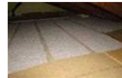
Primer izolacije ravnega stropa proti podstrehi s celuloznimi kosmiči. Avtor fotografije: Igor Premzl
