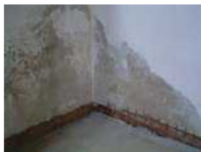
Poškodbe zaradi vlage na vkopanem delu stavbe. Avtor fotografije: Nataša Kolenc
