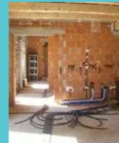
Izvedba novega prečnega nosilnega zidu v kamniti hiši, zidanega iz modularne opeke. Avtor fotografije: Dario Grilanc
