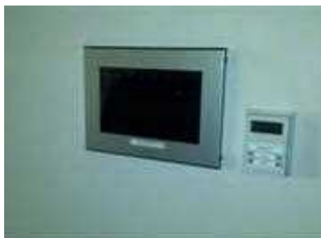
(88) Centralni nadzorni sistem
