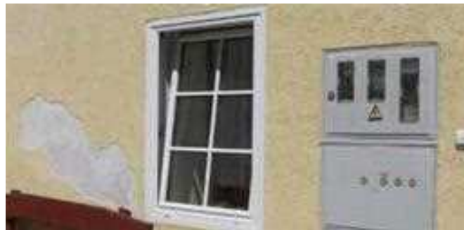
Slika/Abbildung 41: Plastično okno, ki na prvi pogled posnema tradicionalno delitev na šest polj, vendar je pri tem razvrednoten tako njegov estetski kot funkcionalni pomen – jasno je razvidno, da gre za enokrilno, tipsko izdelano okno / Plastikfenster, das auf den ersten Blick die traditionelle Teilung auf sechs Felder nachahmt, jedoch ist hierbei sowohl seine ästhetische als auch funktionelle Bedeutung entwertet – es ist klar ersichtlich, dass es sich hierbei um ein einflügeliges, typisch hergestelltes Fenster handelt
