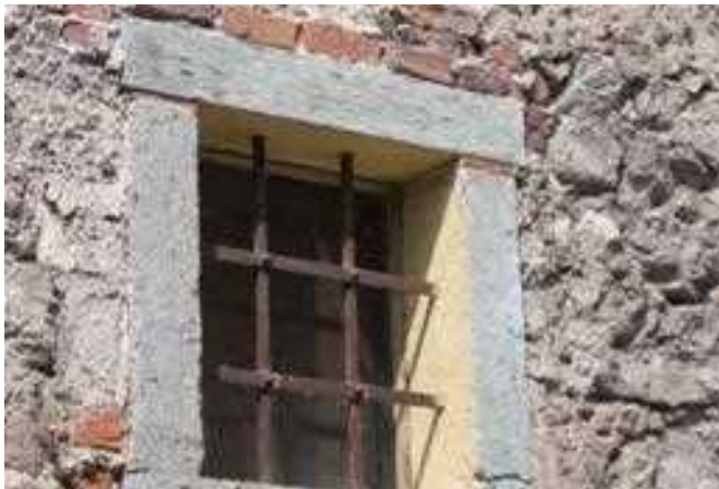
Slika/Abbildung 19: Ker je omet z leti odpadel, je kamnita gradnja jasno vidna. / Weil der Putz mit den Jahren abgefallen ist, wurde der Steinbau klar sichtbar (Leše pri Tržiču)
