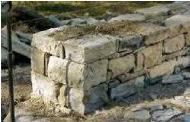
Pravilno zgrajen vogal/Pravilno izgrađen ugao
