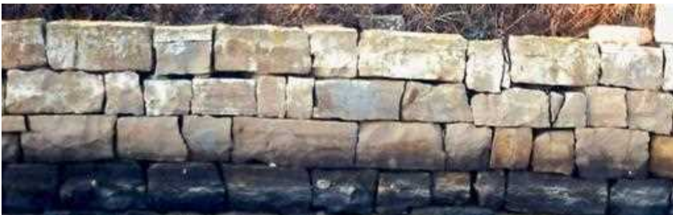
Podporni zid brega kanala v Sečoveljskih solinah/ Potporni zid obale kanala u Sečoveljskim solinama
